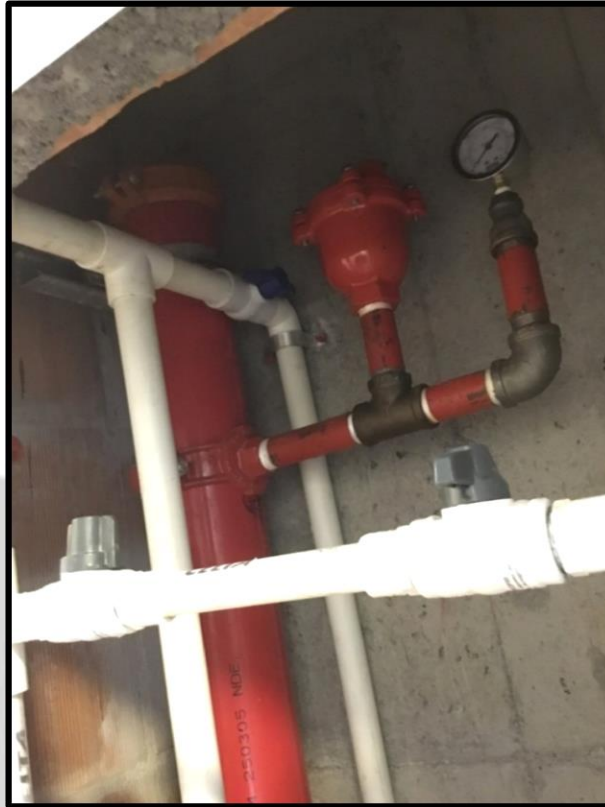
TUBERÍA Y ACCESORIOS RCI
