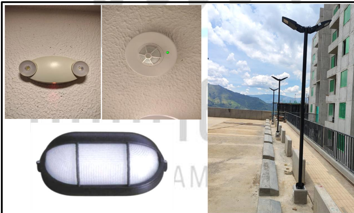
LUMINARIAS Y SENSOR DE MOVIMIENTO
